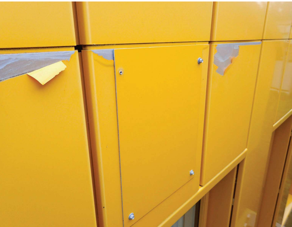
Signifikante Lackfilm-Ablösung infolge Unterrostung des Aluminiums.
